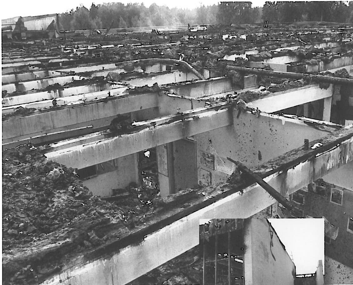
Branden i Haganässkolan i Älmhult kostade Brandförsäkringsverket över 33 miljoner.
